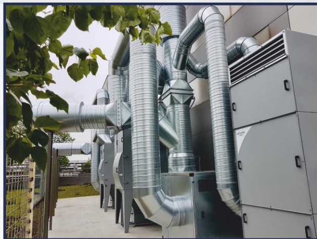
Zespół filtracyjny GM24V XXL o mocy 90kW w obudowie dźwiękochłonnej z zespołem nawiewnym ZPP 18000 wraz z układem zima-lato
