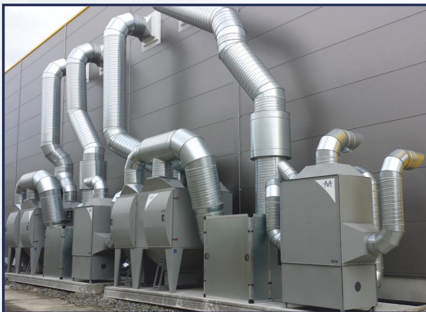
Zespoły filtracyjne GM15V z wentylatorami o mocy 22kW w obudowach dźwiękochłonnych oraz zespołami nawiewnymi ZPP3500
