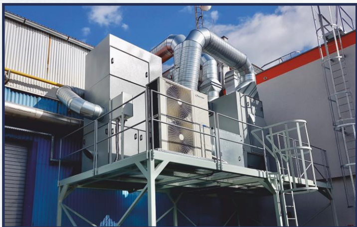
Zespół filtracyjny GM9V XXL o mocy 22kW w obudowie dźwiękochłonnej z zespołem nawiewnym ZPP 1600
