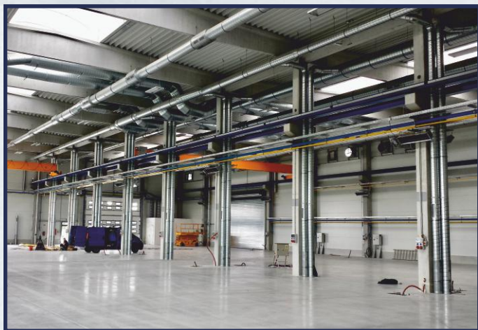
Instalacja TCL - na zdjęciu widoczne kolumny nawiewne i zespoły odciągowe
